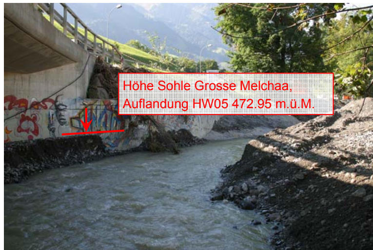
Abb. 4: Brücke Brünigstrasse, Widerlager Seite Sachseln unmittelbar nach HW2005 (Foto 20050913 vom 13.09.05)
