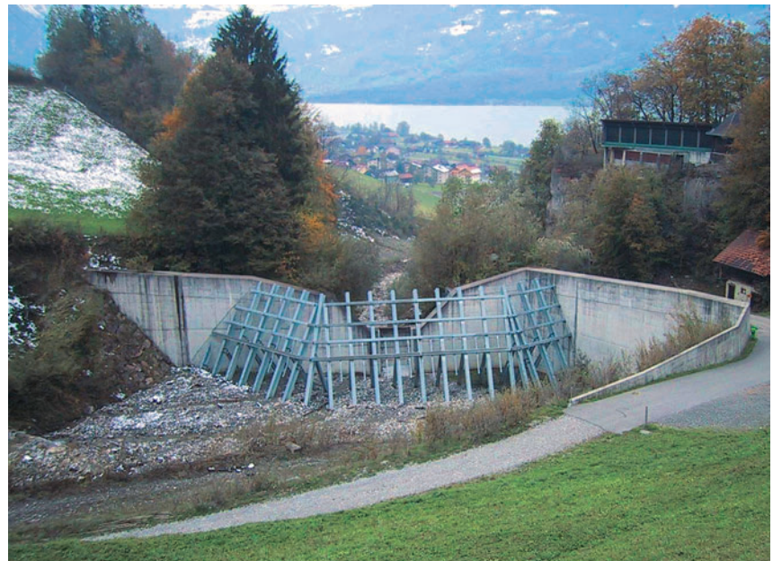
Geschiebesammler mit Grobrechen im Oberlauf des Dorfbaches
