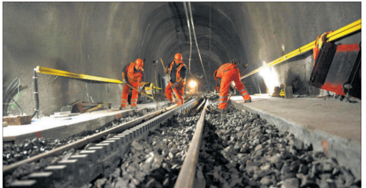
Bauarbeiten im neuen Tunnel nach Engelberg. Das Bild ist vom April, schon bald fahren die ersten Züge hindurch.
