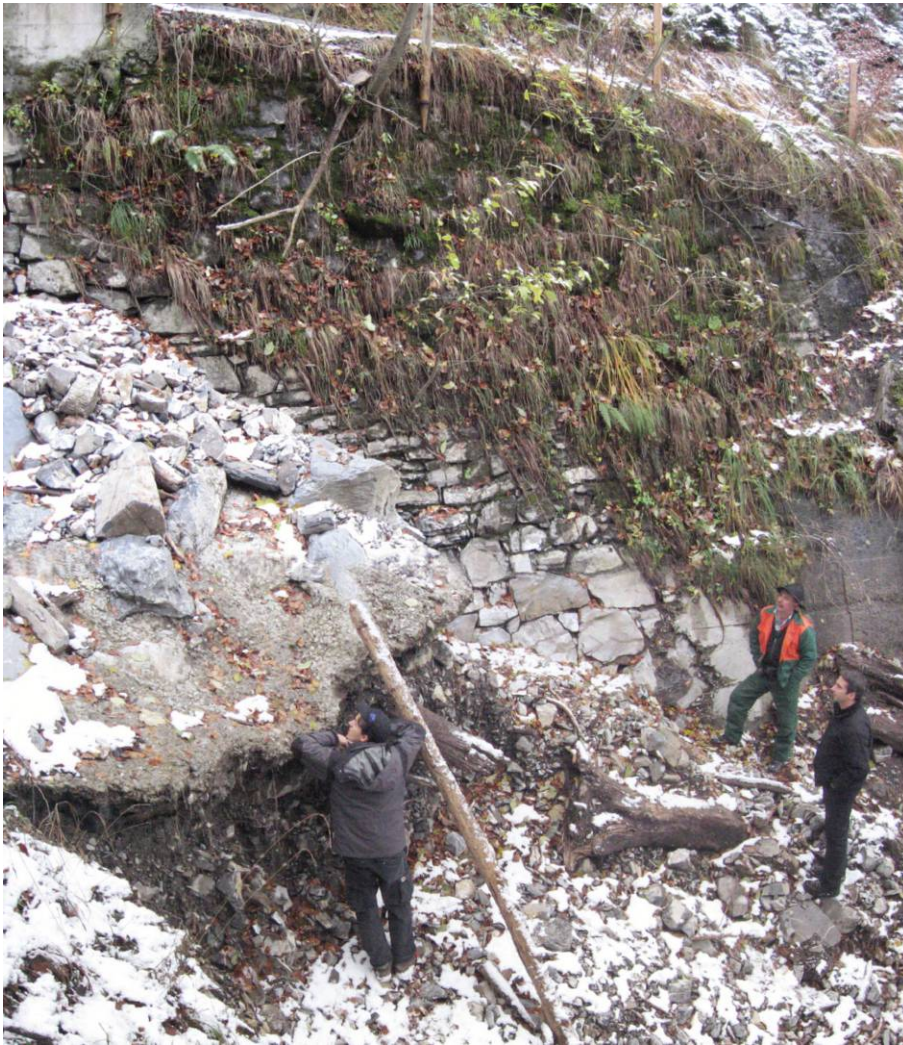
Abb. 1: Starke Sohlenerosion unmittelbar unterhalb der Brunnenmadstrasse, Fundationstiefe der Stützmauer unbekannt, 13.11.2007
