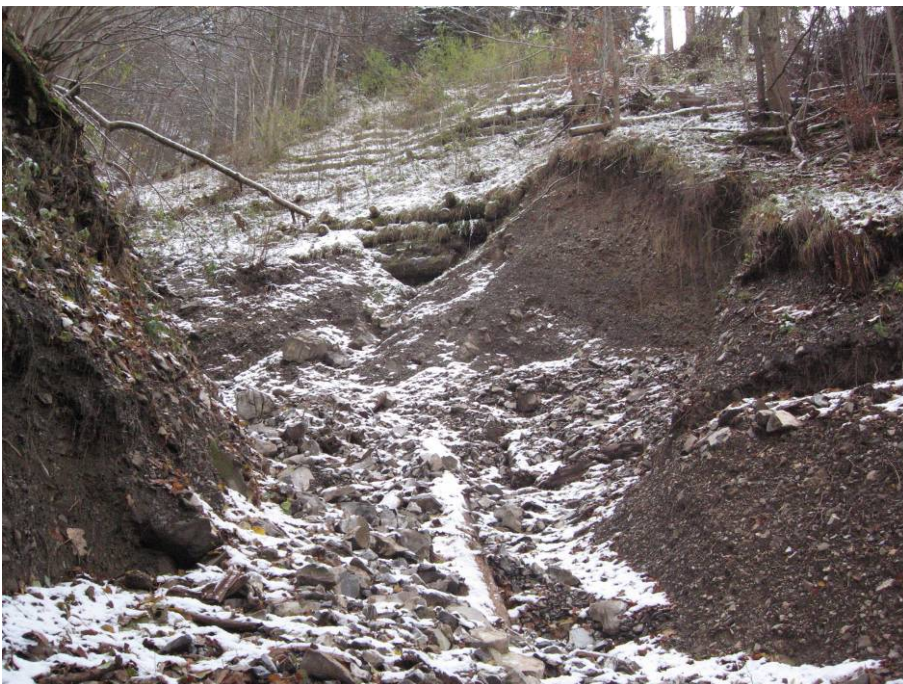
Abb. 2: Erosionsloch (Kote ca. 850) und Sohlenerosion im südwestlichen Seitengraben unterhalb der Brunnenmadstrasse, 13.11.2007
