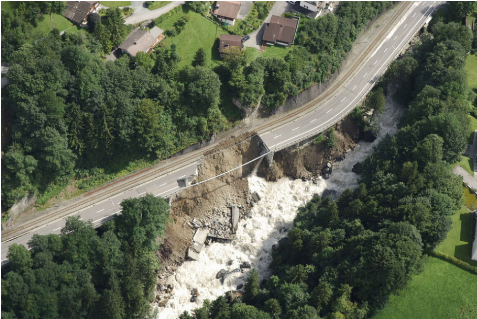
Abbildung 29: Engelbergeraa mit eingestürztem Lehnenviadukt.
